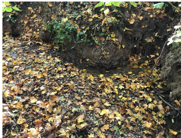
Oevererosie door verplaatsing grind 12-11-21
