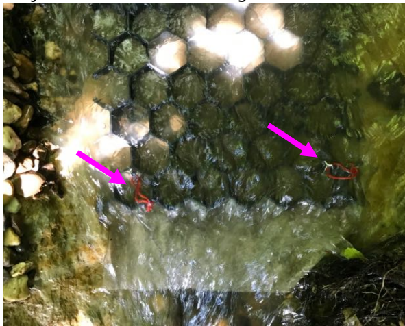
Grondpen ter verankering benedenstrooms
