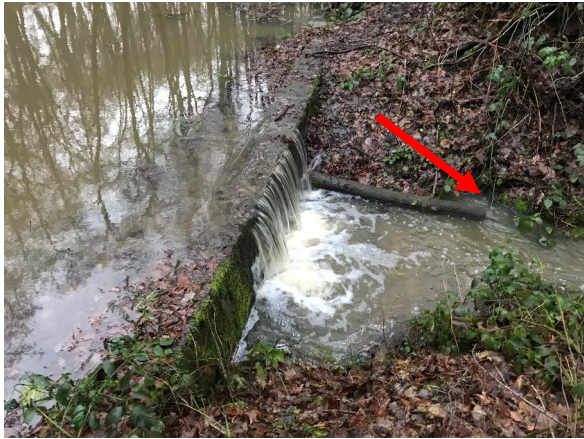
V-vormige drempel met lekkage
