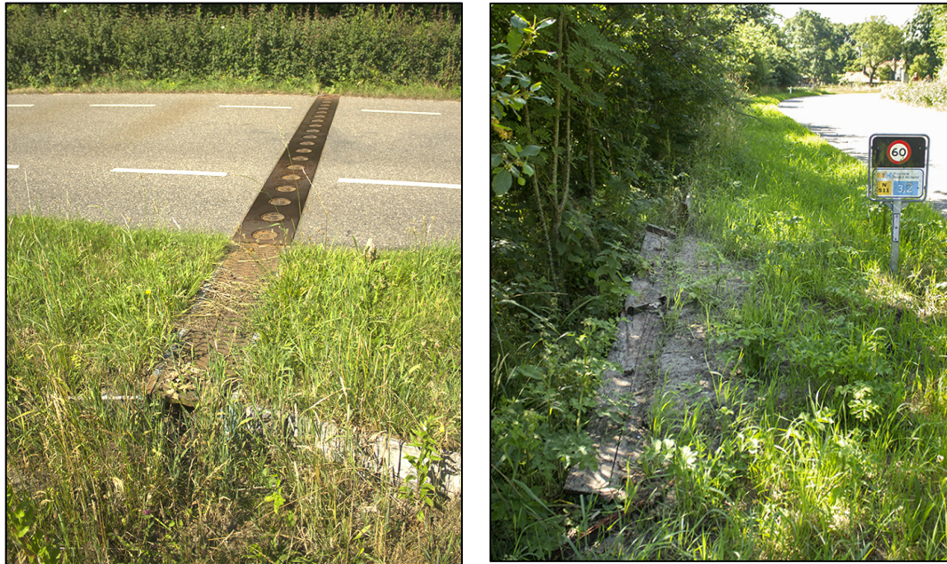
Figuur 2.6 Amfibieëntunnels onder de N511 d.d. 5 juli 2017. Links zijn de schermen en de ingang overgroeid met gras waardoor dieren over de schermen kunnen klimmen. Rechts is een deel van het scherm beschadigd waardoor dieren de weg kunnen bereiken (Foto's: Annette Karels).
