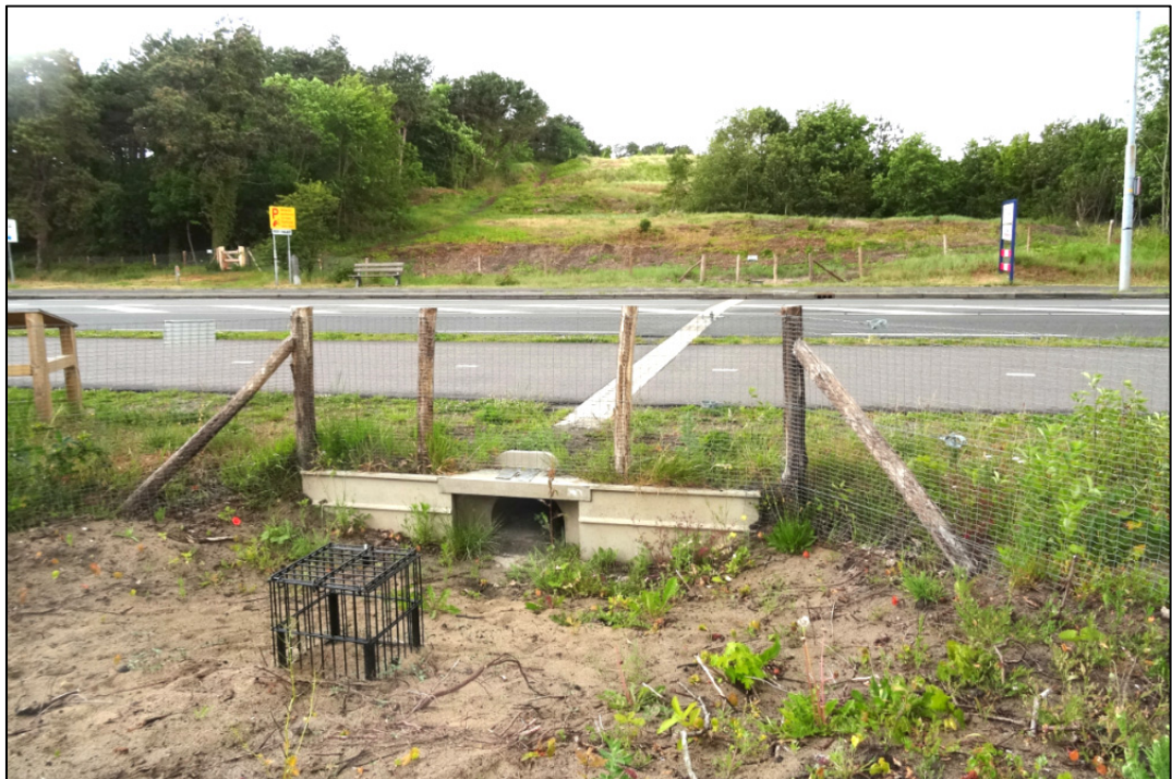
Figuur 2.12 Faunatunnel onder de Egmonderstraatweg (Foto: PWN).
