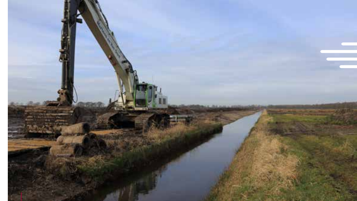
Werkzaamheden in natuurgebied Vlijmens Ven - Honderd Morgen: verwijderen van de bouwvoor ten behoeve van de ontwikkeling van natte schraalgraslanden. Foto: Fons Mandigers
