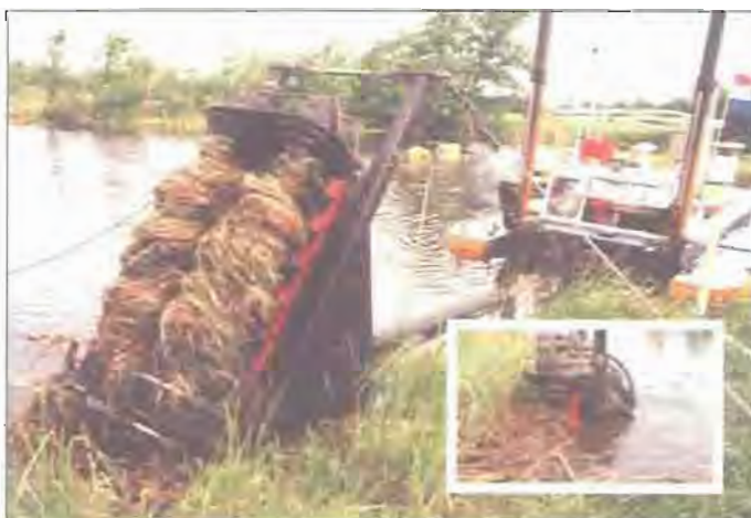
Figuur 51. De Kraggenvreter, een drijvend apparaat ontwikkeld door Staatsbosbeheer om nieuwe petgaten te creëren. Ve inclusief vegetatie wordt verwijderd door de arm van de machine, gemengd met water en via een pijpleiding afgevoerd naar een depot. Inzet: de arm aan het werk onder water. Foto: L. Brouwer, SBB De Weerribben.
